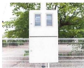
配電盤防水パッキン
